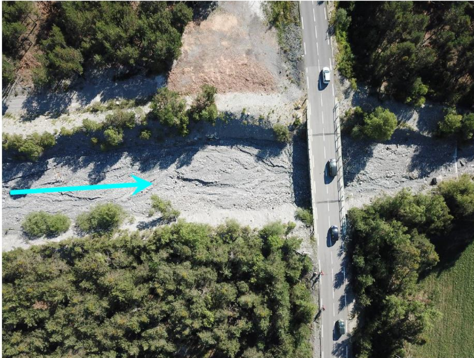
Photo 25 : Recul "naturel" de la berge en amont du pont.
