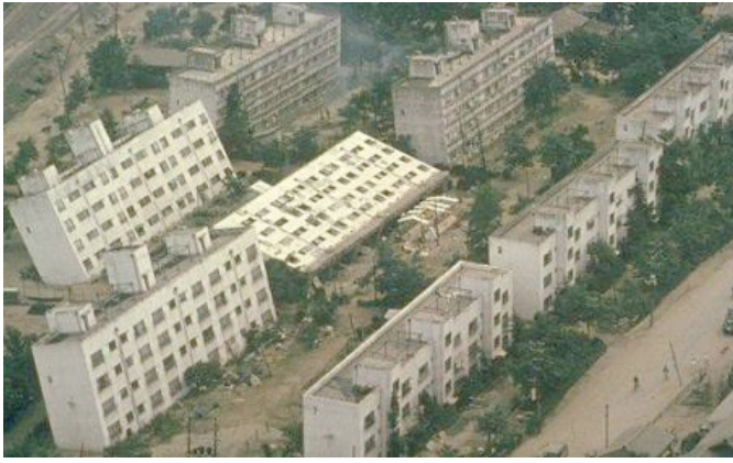
Exemple de dommage dû à l'environnement. Tassement de la structure dû à la liquéfaction
