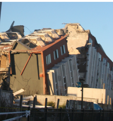
Exemple d'une construction en béton armé endommagée lors du tremblement du Chili (2010). Même en béton armé, un mauvais respect des règles de conception entraîne la destruction complète de la structure.
