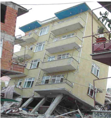
Exemple de dommage dû à l'irrégularité en hauteur. Étage transparent ou souple.
