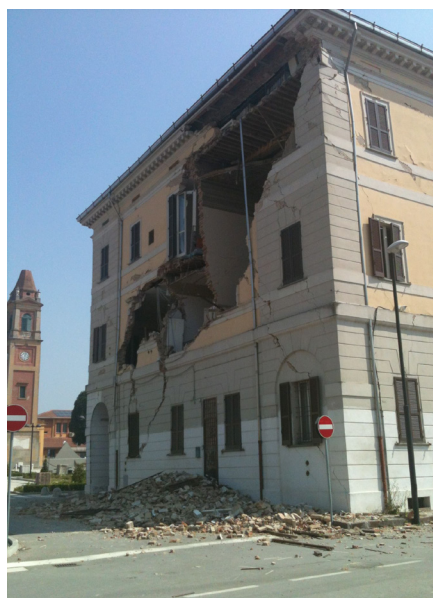
Séisme d'Emilia Romagna (Italie, 2012) . Exemple de dommages observés pour un séisme de magnitude modérée (M=6) sur des bâtiments industriels et historiques.
