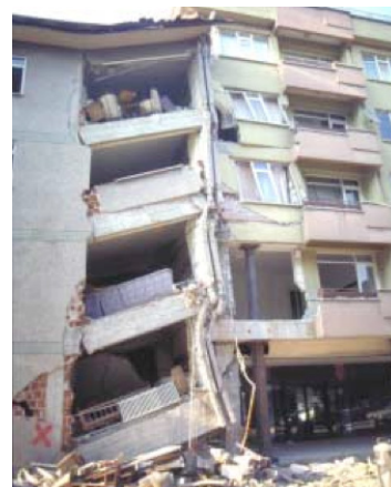
Exemple de dommage dû à l'environnement. Chocs entre deux bâtiments adjacents.
