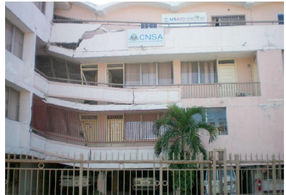
Exemple de dommage dû à l'irrégularité en plan. Structure irrégulière de forme.
