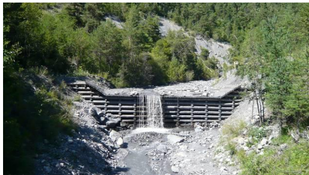
Barrage RTM en bois (Riou-Bourdoux)
