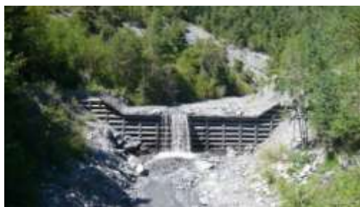
Barrage RTM en bois (Riou-Bourdoux)
