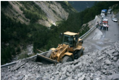
Eboulement à la Rochaille - Commune de Meyrannes © Service Restauration des terrains de montagne (RTM) des Alpes-de-Haute-Provence
